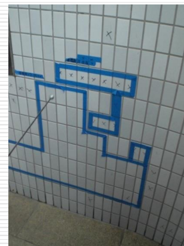
タイルの浮き部
