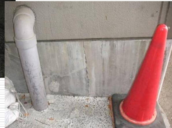
ひび割れの兆候
