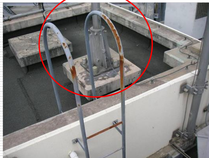
機器のサビや劣化を確認
