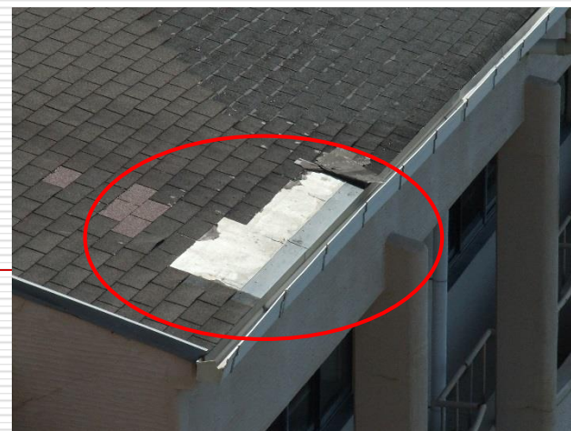
屋根仕上材の欠損
