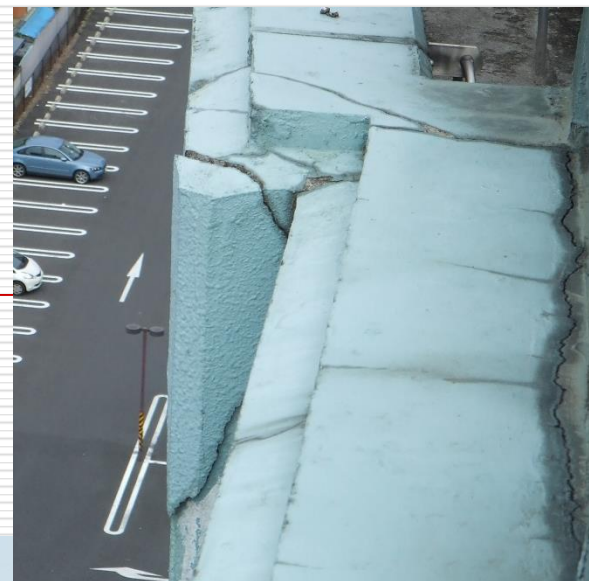
コンクリート欠落寸前
