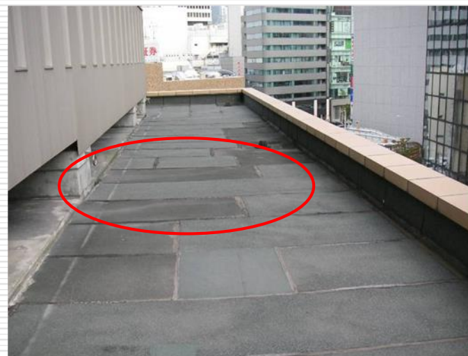
屋上防水の浮きを確認
