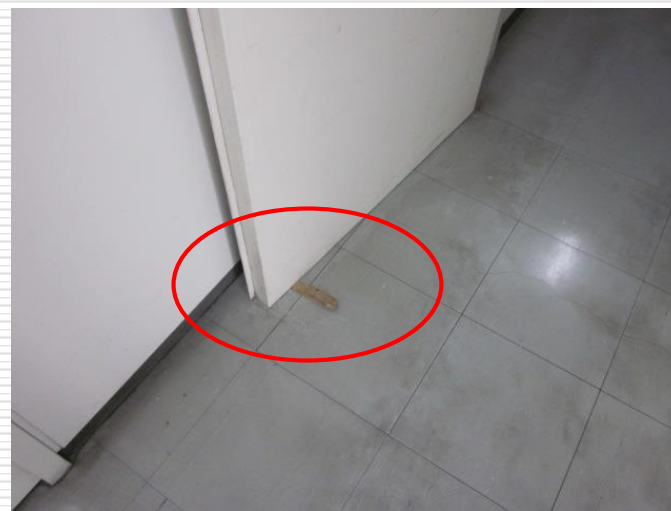
防火戸が開放状態で固定されている
